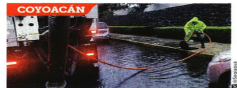
Personal de la Segiagua acudió para liberar la acumulación de agua en vialidades de la Colonia Jardines del Pedregal.
