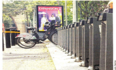
Estaciones de Ecobici lucen vacías, con bicicletas en mal estado y fallas en el equipo, entre otras deficiencias.
